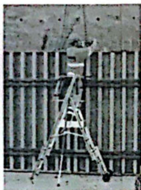
1 Scala mobile con piattaforma
